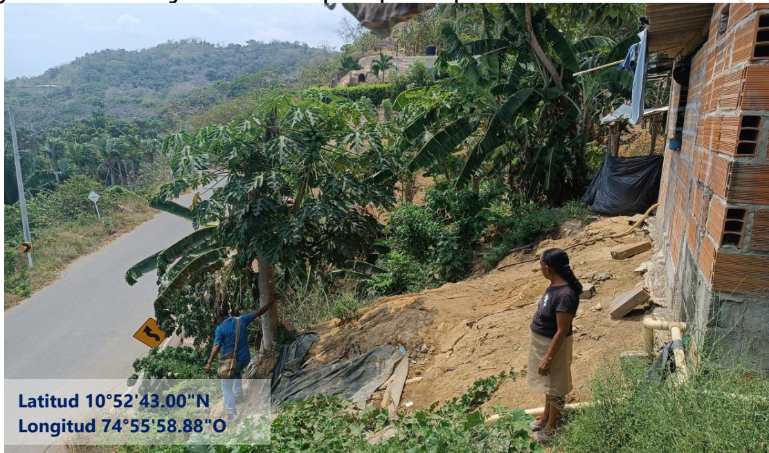
Figura 1.62. Vivienda Olga Romero con colapso de parte del predio en corte de vía Guaimaral – Paluato
