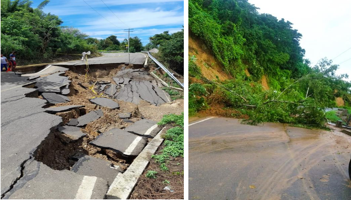
Figura 1.60. Colapso de vía y deslizamientos Guaimaral Tubará
