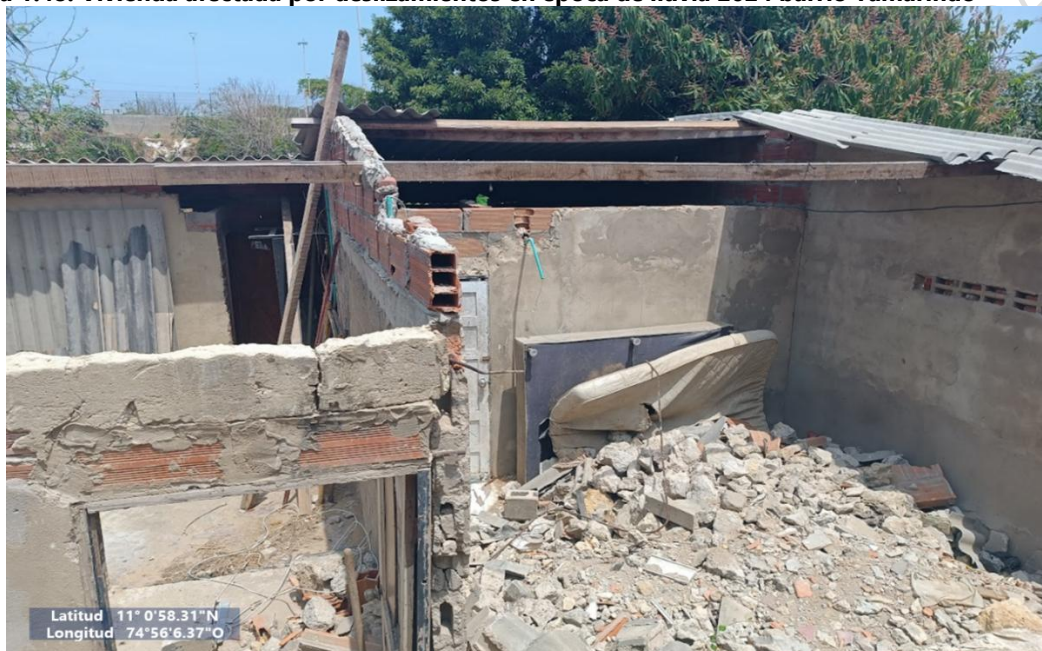
Figura 1.48. Vivienda afectada por deslizamientos en época de lluvia 2024 barrio Tamarindo
