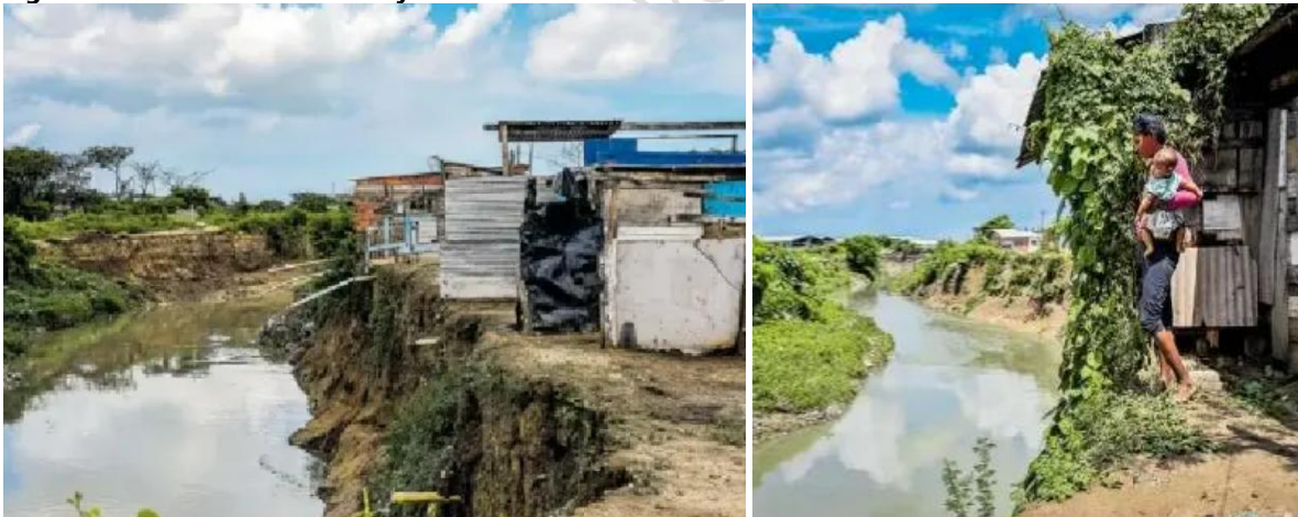
Figura 1.56. Socavación de Arroyo León
