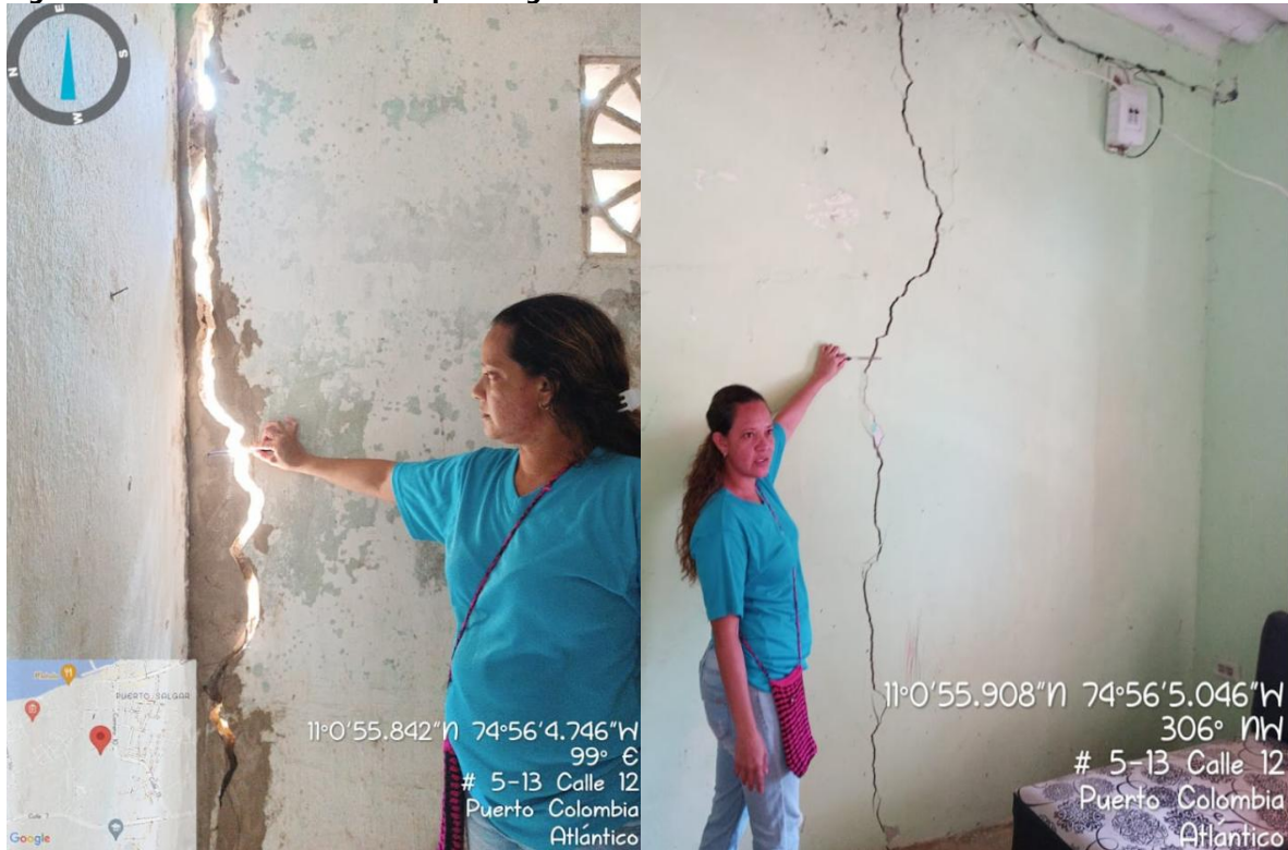
Figura 1.46. Vivienda abandonada por riesgo en Tamarindo Erika Castro
