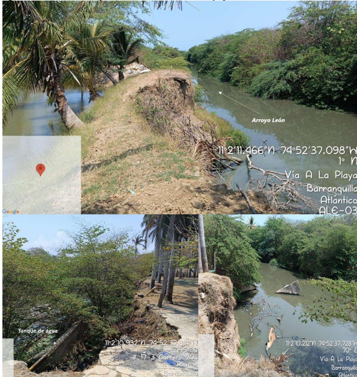
Figura 1.53. Socavación Arroyo León Finca Prisma Nova vía la playa – sabanilla
