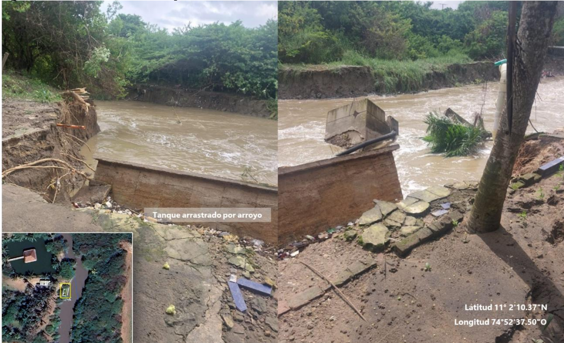
Figura 1.33. Inundaciones Arroyo León en sector vía sabanilla , Finca Prisma Nova
