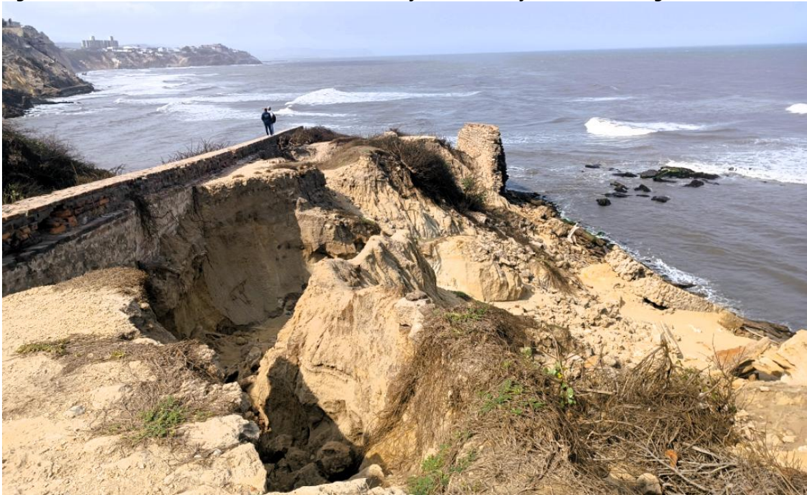
Figura 1.50. Socavación en sector occidental (arriba) y oriental (abajo) Castillo de Salgar
