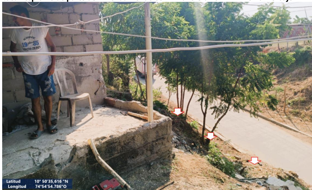
Figura 1.58. Desplome de parte de vivienda Henderson Amaris Cra 15 # 11-120 Barrio bajo
